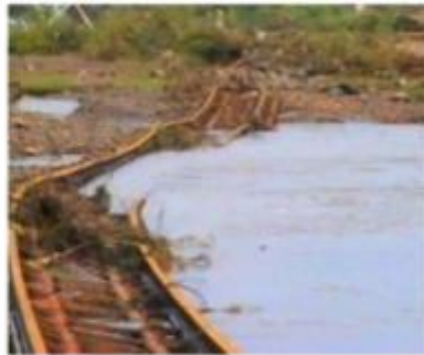
(D) Collapsed railway line - Nagore
